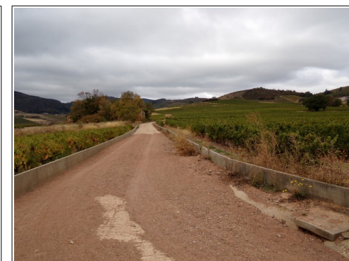
Illustration 9: concentration d'écoulements et ensablement d'un chemin viticole près du lieu-dit Gonnu.
