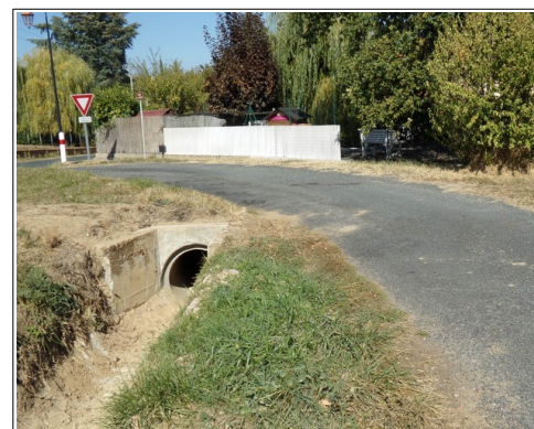
Illustration 139: busage de l'axe d'écoulement de Fond d'Arbuissonnas ; on notera le diamètre de la buse et le risque de débordement qui se dégage de l'ouvrage.
