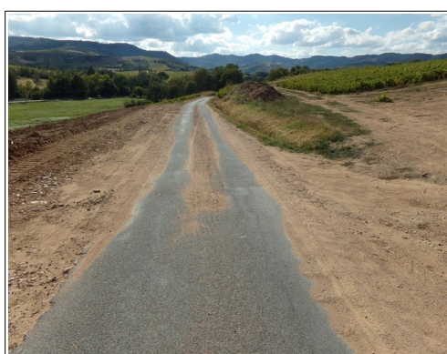
Illustration 57: ruissellement et ensablement de chaussée au lieu-dit Fond de Vaux.
