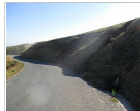
Illustration 146: Glissement d'un talus au lieu-dit Le Plageret
