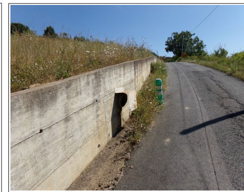
Illustration 20: buse collectant des ruissellements et se déversant sur le chemin de La Roche (ouest de la commune).
