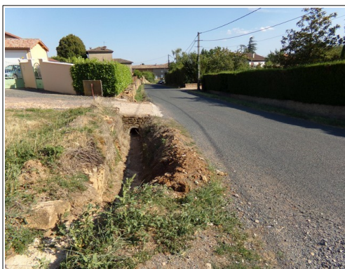
Illustration 17: zone de ruissellement possible sur la RD19 à l'entrée nord du village.
