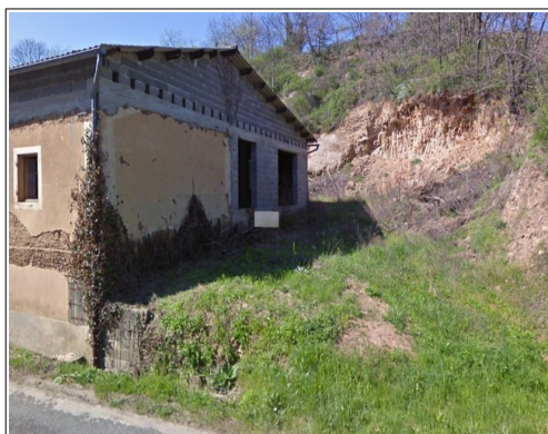
Illustration 143: talus rocheux à l'amont d'une maison près du lieu-dit En Bussy.
