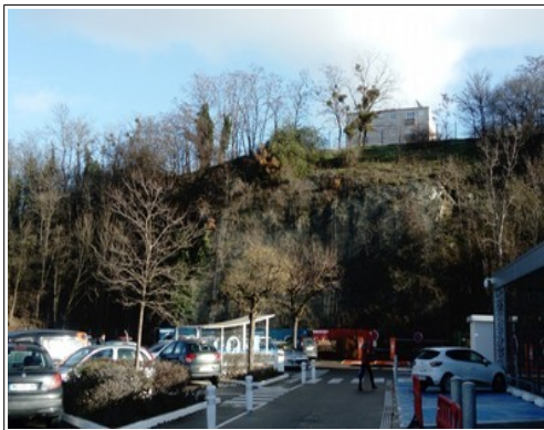
Illustration 176: Talus protégé par un filet pendu - sous la cité Belleruche
