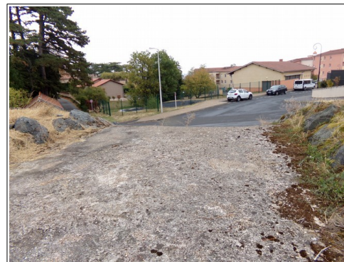
Illustration 7: déversoir de crue du bassin d'orage du village orienté en direction de la rue Courajod.
