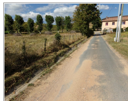
Illustration 58: exemple d'écoulement sur chaussée au Fond de Vaux traduit aléa fort (V3) (axe préférentiel d'écoulement).
