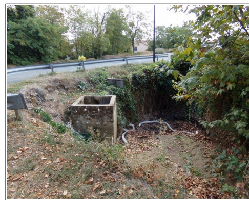
Illustration 137: bassin d'orage du hameau du Briey en bordure de la RD19.
